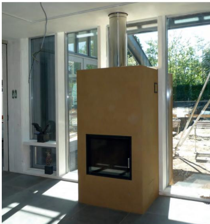
De hoogrendement (tegenstroomsysteem) leemkachel is samen met de buitenhaard op een dubbelwandige rvs-afvoerpijp aangesloten.
